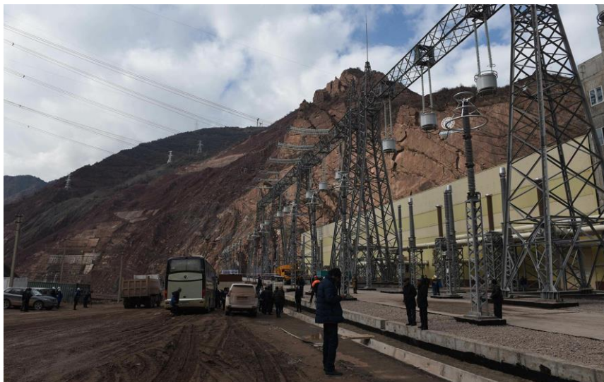
Рис. 4.12. Передача электроэнергии по линии ЛЭП-500 кВ «Рогун – Душанбе»
